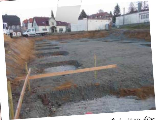
...hier beginnen die ersten Arbeiten für das neue Feuerwehrgerätehaus (Bodenverbesserung für einen tragfähigen Baugrund)
