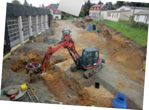
Das Gebäude ist zum großen Teil fertiggestellt. Nun wird an den Außenanlagen gebaut...
